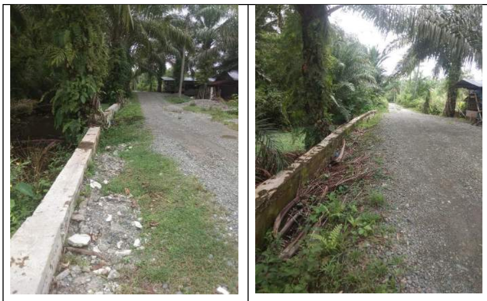
Gambar 4.1 Talud Jalan Desa Gampong Keuramat (2021) Sumber: Dokumentasi di Gampong Keuramat
