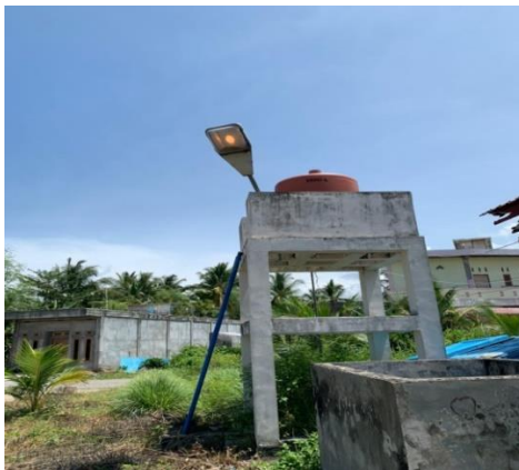
Instalasi air bersih
