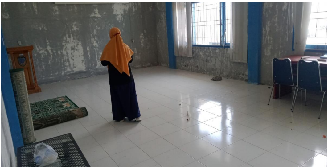
Gambar : A.4.4 Kondisi Lantai Pada Bangunan Gedung
