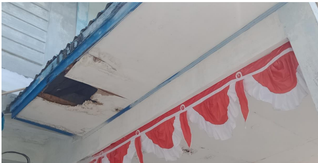
Gambar : A.4.3 Kondisi Plafon Pada Bangunan Gedung
