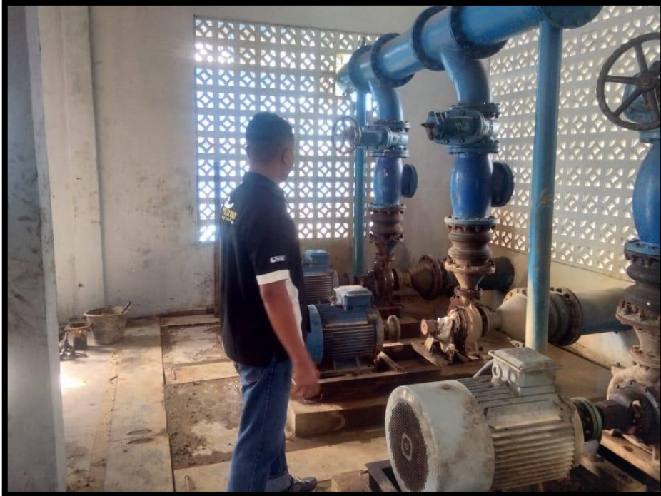
Lampiran 1.15. Melihat Kondisi Mesin Pengolahan Air PDAM
