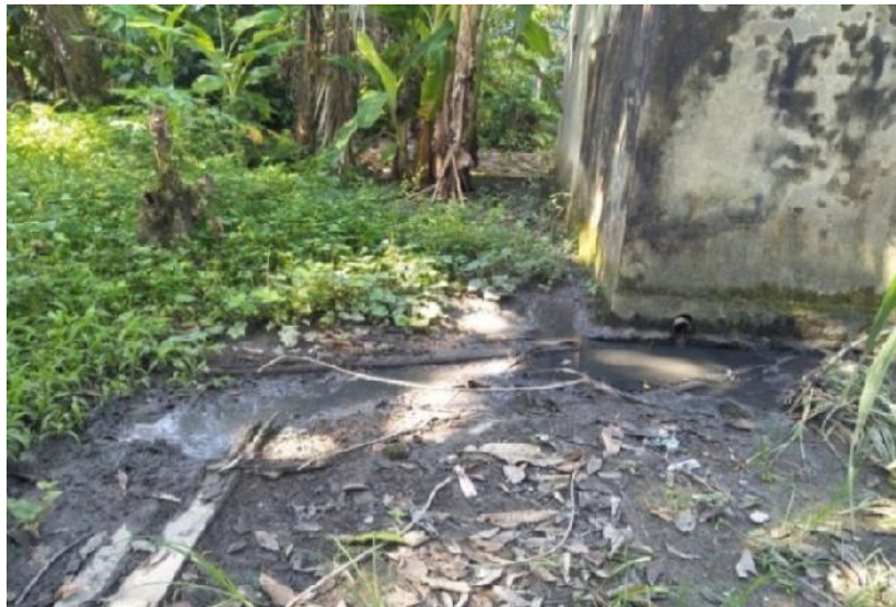
Foto 8: Kondisi Saluran Pembuangan Air Limbah Yang Tergenang
