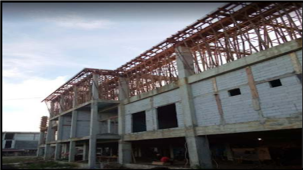
Gambar A. 5 : Pembangunan R.S. Regional Cut Nyak Dhien Sumber : Pengambilan Dokumentasi di Lapangan, 2022.
