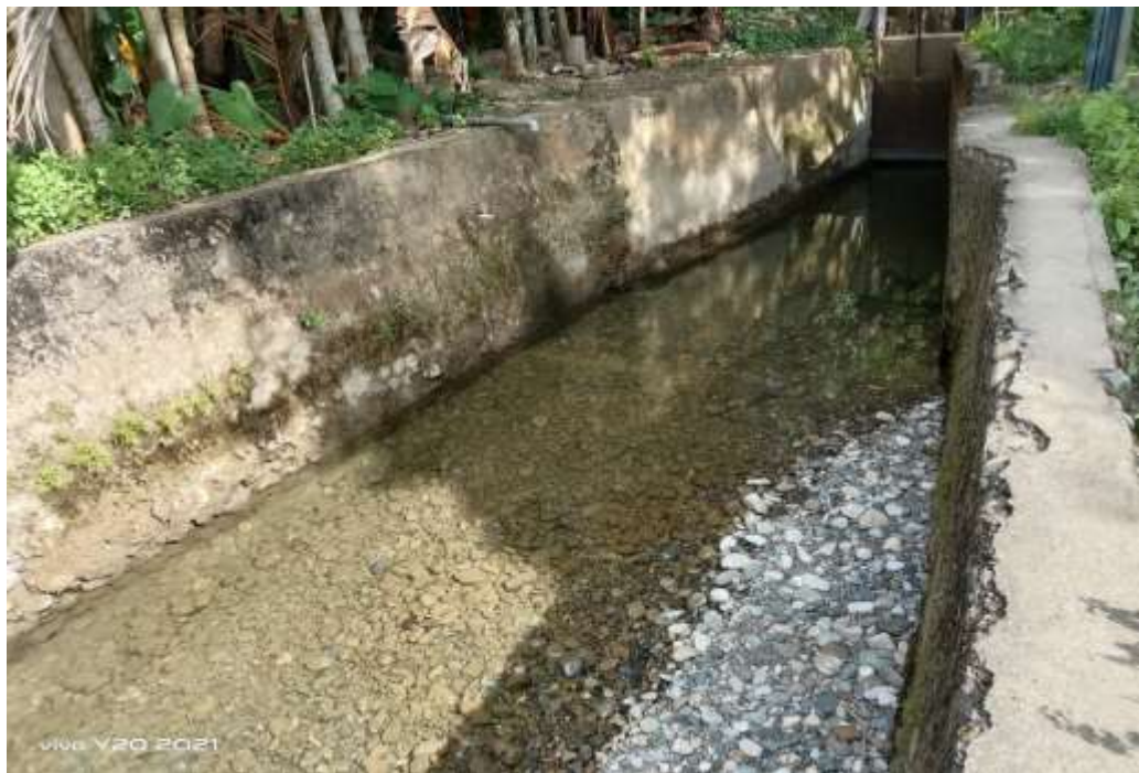
Gambar A.4. 1 : Kondisi kerusakan Dinding Saluran dan Sedimentasi Sumber : Dokumentasi Lapangan
