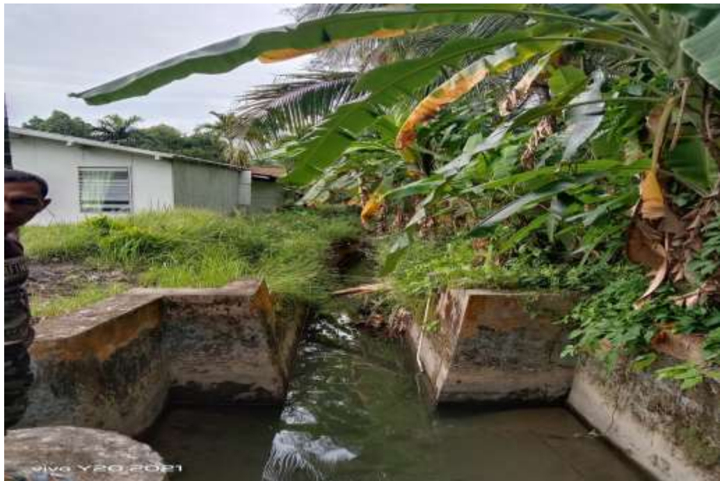
Gambar A.4. 3: Kondisi Saluran Yang dipenuhi sampah Sumber : Dokumentasi Lapangan
