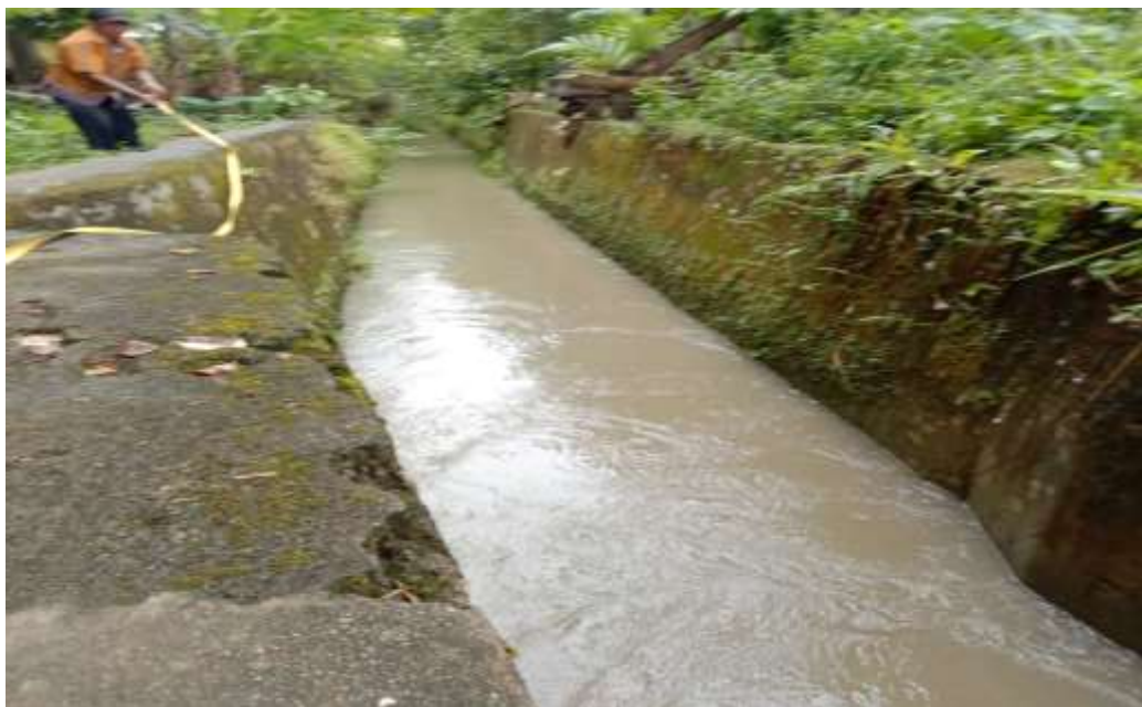
Gambar A.4. 4: Kondisi Saluran yang mengalami vegetasi Sumber : Dokumentasi Lapangan
