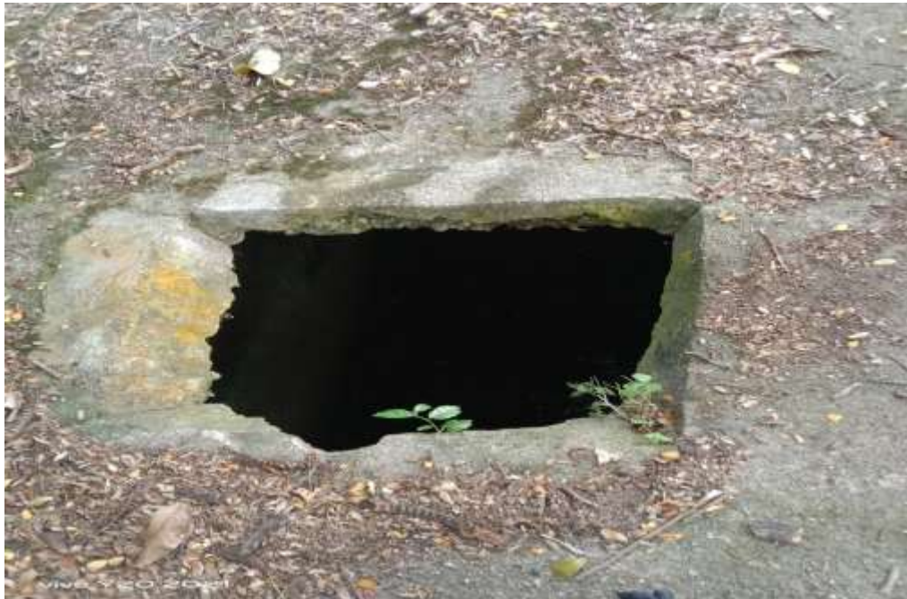
Gambar A.4. 2: Kondisi Kerusakan penutup Saluran Yang Berlubang Sumber : Dokumentasi Lapangan
