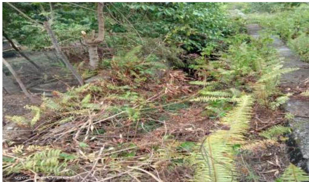
Gambar A.4. 5: Saluran irigasi yang penuh oleh rumputan Sumber : Dokumentasi Lapangan
