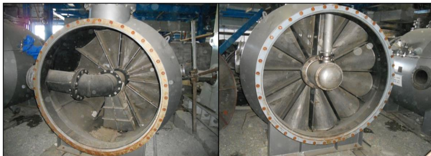
Gambar 2.8 Debris Filter ( Sumber : PLTU Pembangkitan Nagan Raya )
