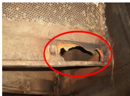
Gambar 3.7 Kerusakan Plat Strainer (Sumber PLTU Nagan Raya)
