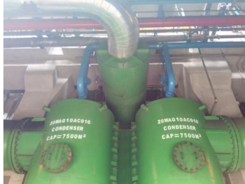
Gambar 2.9 Kondensor (Sumber : PLTU Pembangkitan Nagan Raya)
