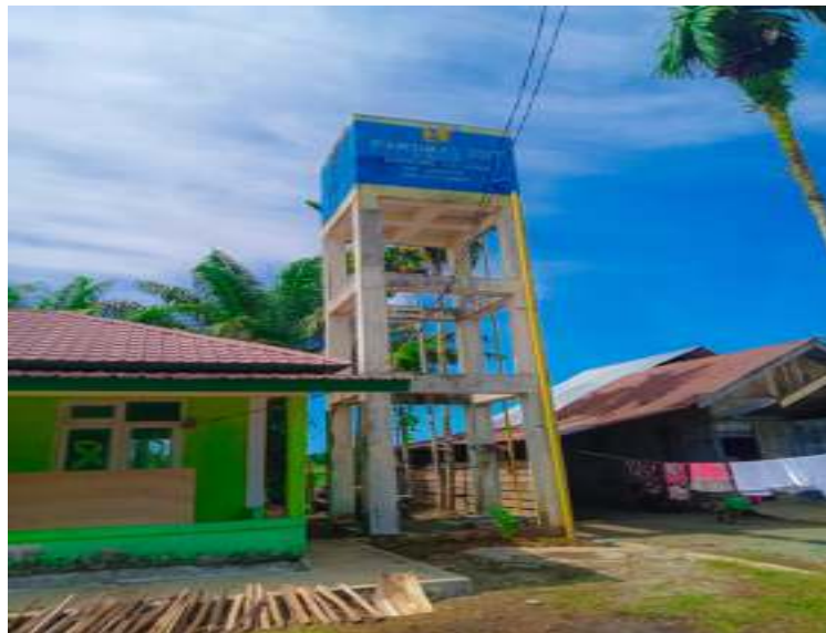
Gambar 5.3 Lokasi Tower Penampung air PAMSIMAS
